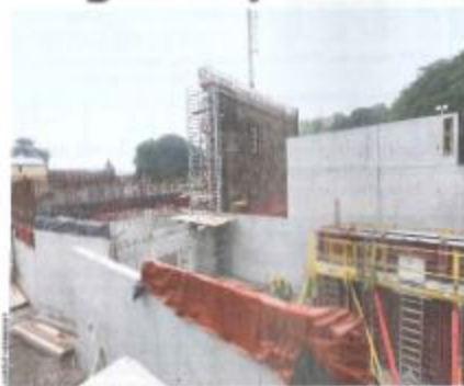
L'entreprise Albezati, en charge du gros œuvre, utilise des techniques originales pour assurer le jeu complexe des volumes conçus par l'architecte Dominique Coulon.
