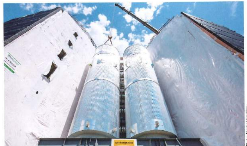
Le stockage intersaisonnier alimente l'eau chaude et les circuits de chauffage.
