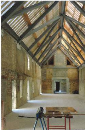
▲ La nouvelle charpente métallique repose sur un cadre en acier couronnant la maçonnerie.
